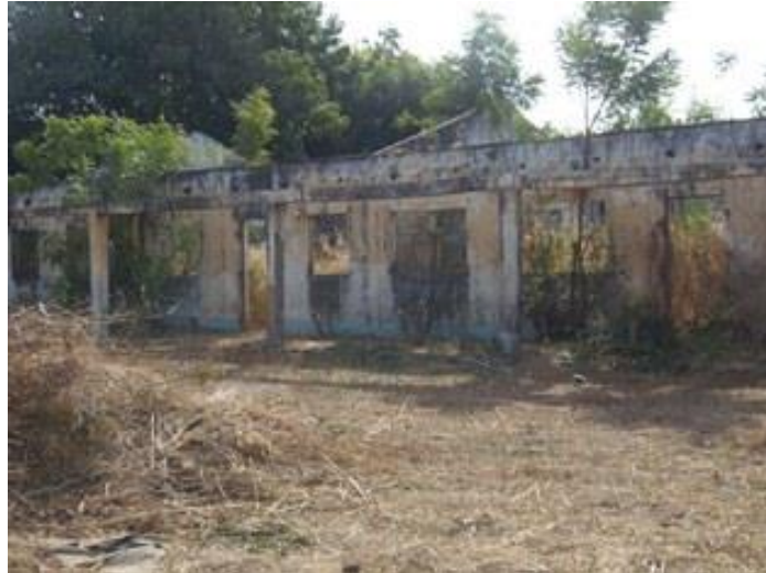
De kosten voor de renovatie van het totaal verwoeste gebouw bedragen € 18.500,00
